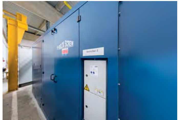
Abb. 3: Die Erfahrungen mit Aerzen Technik sind so gut, dass der gleiche Aufbau auch im JTI-Produktionswerk auf Teneriffa zum Einsatz kommt.
